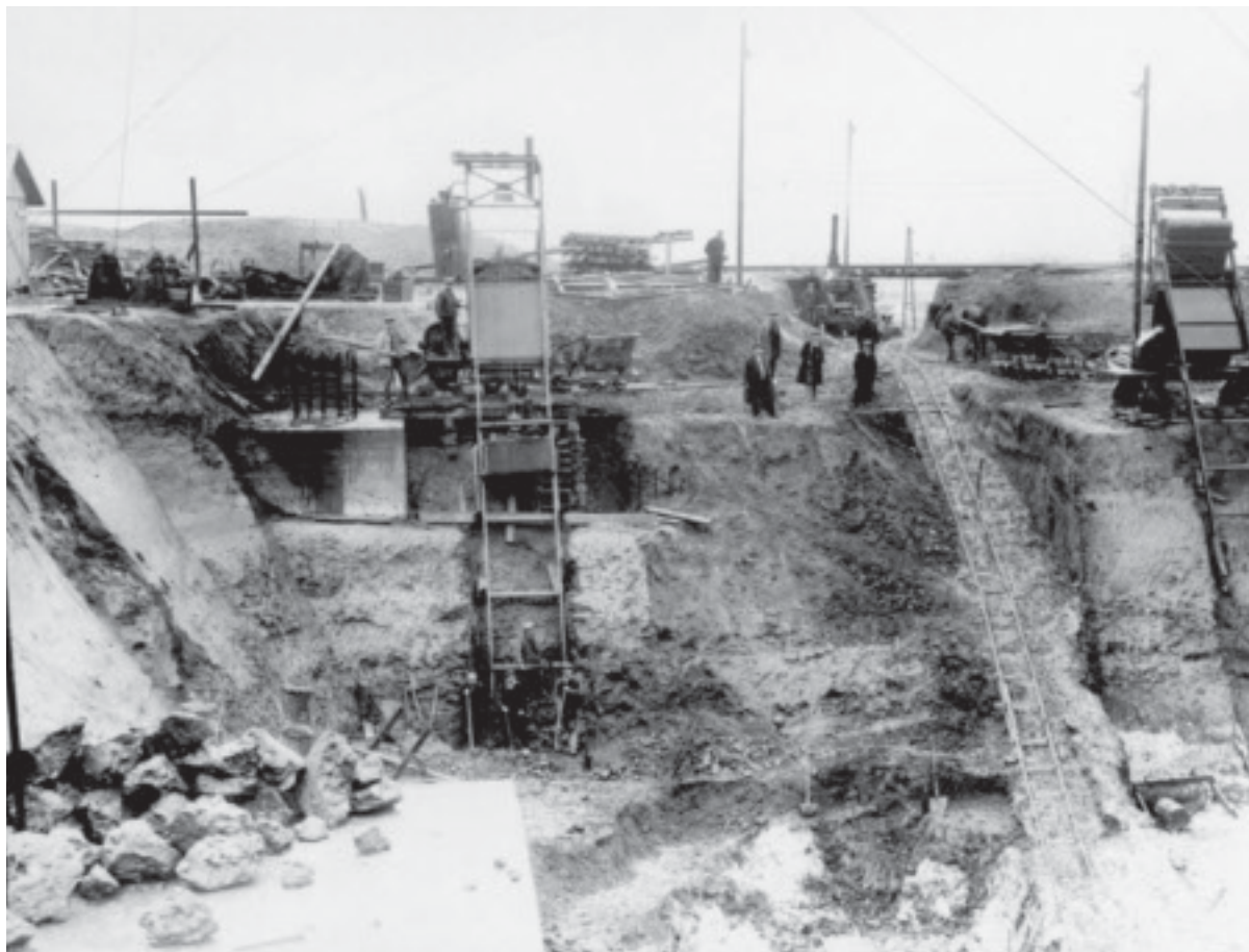
SAICOM, fonds Carbonisation Centrale (collection V. Vincke, creusement des fondations du bâtiment), circa 1929.
