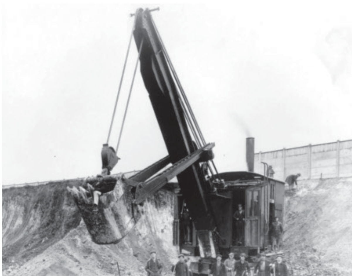
SAICOM, fonds Carbonisation Centrale (collection V. Vincke, creusement des fondations du bâtiment), circa 1929.
