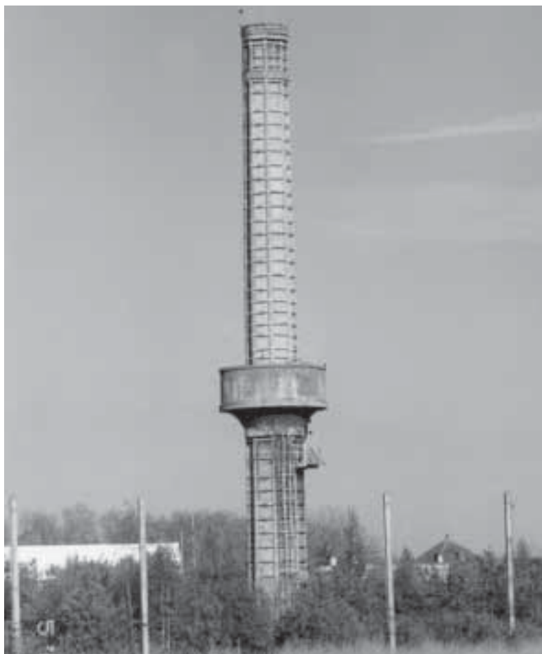
Cheminée en claveaux de béton des laminoirs à chaud de Jemappes, toujours en place avenue Demerbe (cl. de l'auteur).
