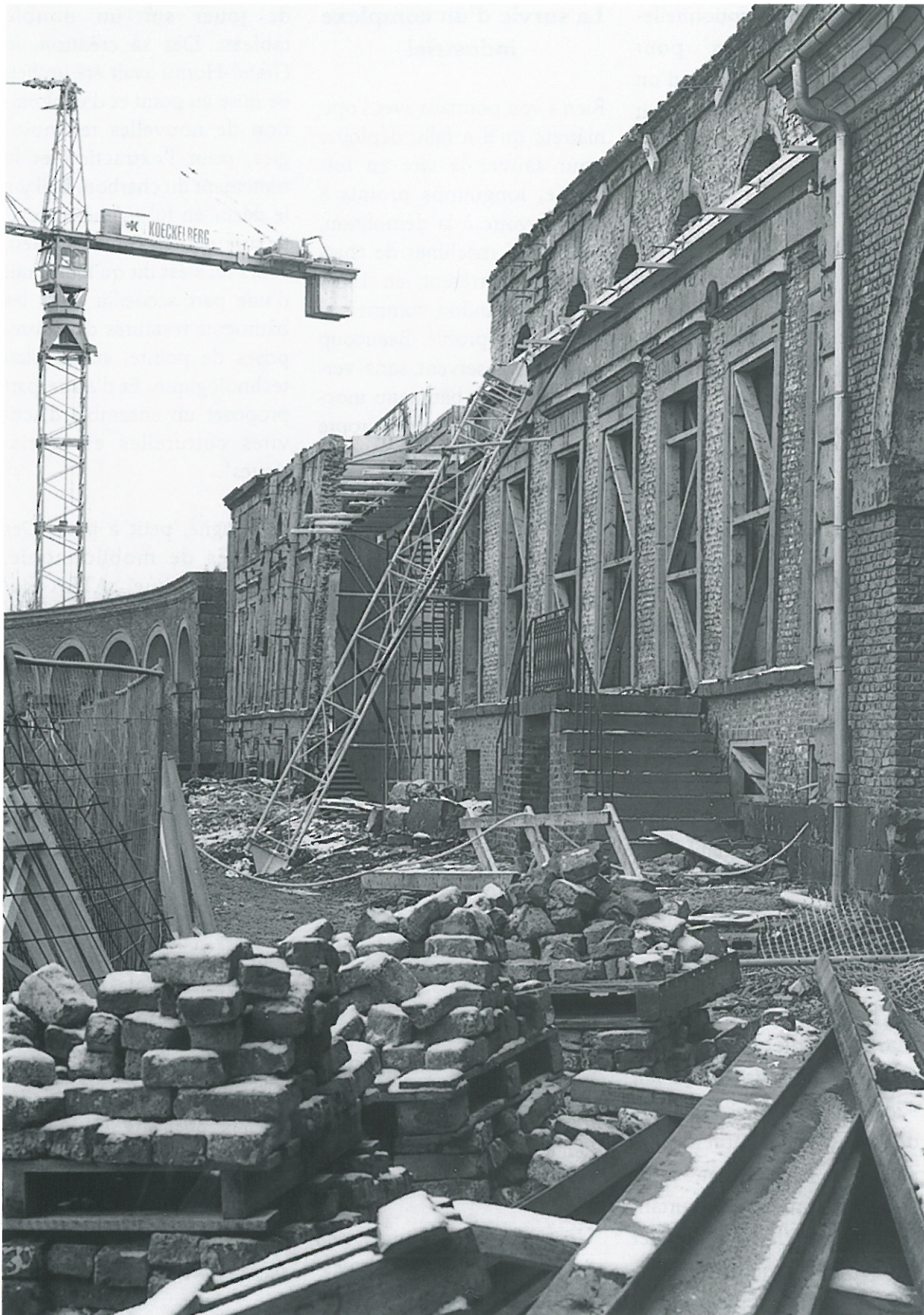
5. Grand-Hornu : chantier du futur "Musée des Arts Contemporains". Photo Grand-Hornu Images ASBL.
